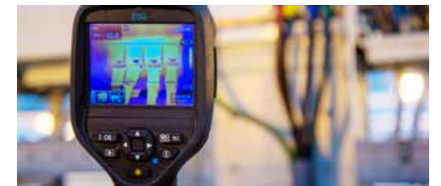
Warmtebeeldopname bedrading onderverdeelinrichting
